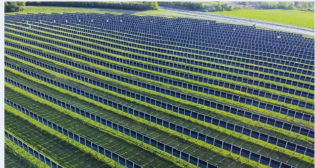
Solarpark Aasen von oben Quelle:Next2Sun GmbH
