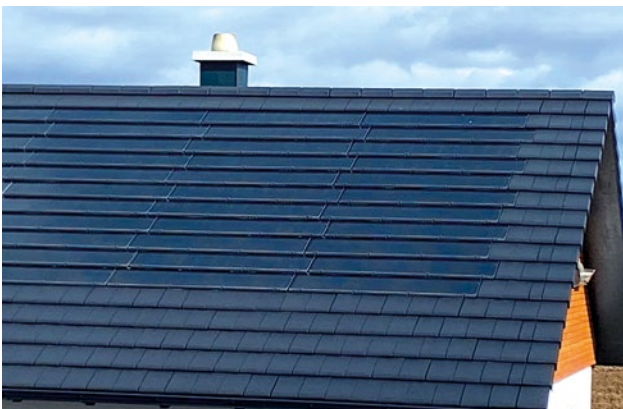
Kaum zu sehen: Dachintegrierte Photovoltaik bei einem Neubau.
